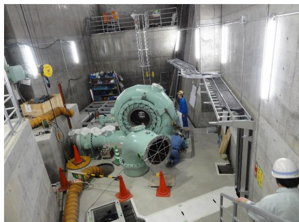
(五十里発電所)
