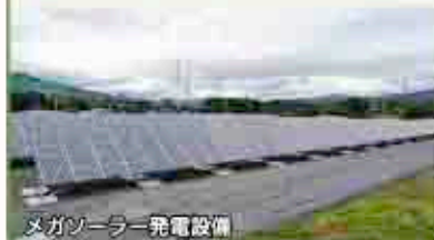
メガソーラー発電設備
